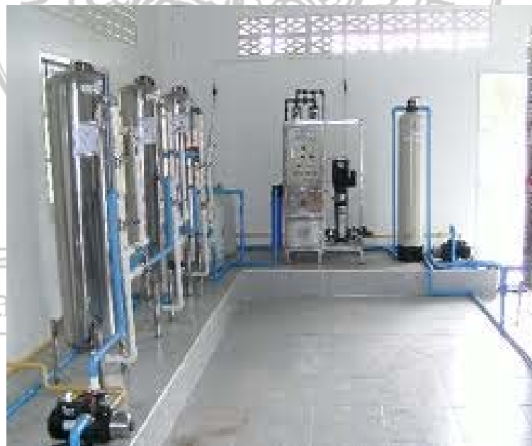
เครื่องกรองน้ำระบบ RO
